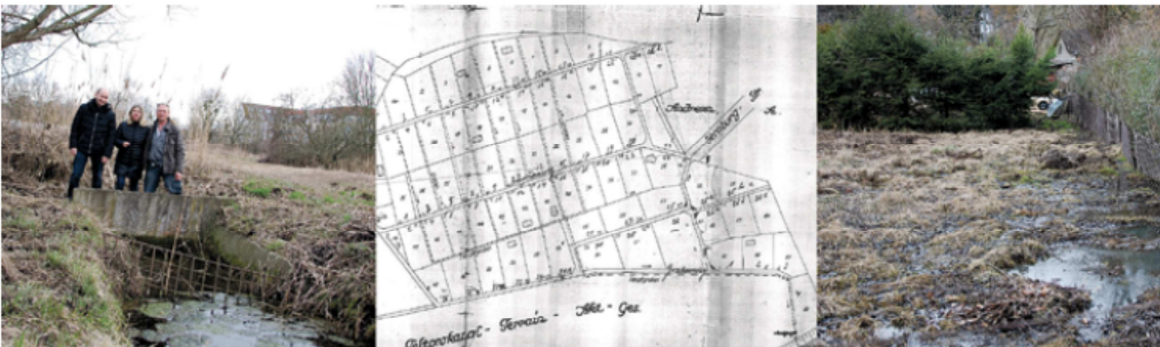
Schäden an dem nicht mehr funktionsfähigen Hauptentwässerungsgraben werden begutachtet (li.), Plan der Entwässerungsanlage aus dem Jahr 1929 (Mi.), Teile Klein Moskaus unter Wasser
